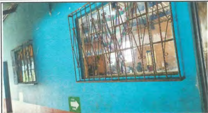
Foto 1: VENTANAS SELLADAS Y EN MAL ESTADO, SUSTITUCIÓN DE VENTANAS POR LAS INCLEMENCIAS DEL TIEMPO (CALOR)
