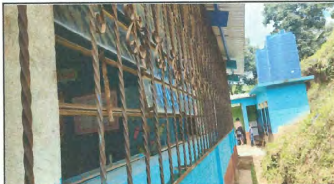
Foto 2: VENTANAS SELLADAS Y EN MAL ESTADO, SUSTITUCIÓN DE VENTANAS POR LAS INCLEMENCIAS DEL TIEMPO (CALOR)
