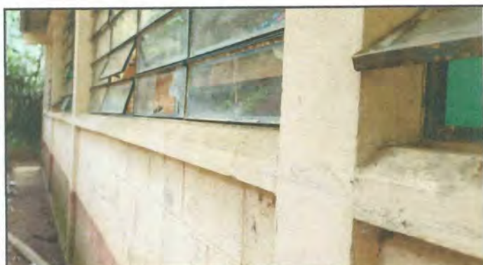
Foto 3: VENTANAS SELLADAS Y EN MAL ESTADO, SUSTITUCIÓN DE VENTANAS POR LAS INCLEMENCIAS DEL TIEMPO (CALOR)
