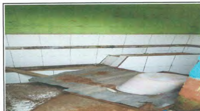
Foto 4: MINGITORIO EN MAL ESTADO, REPARACIÓN DE MINGITORIO
